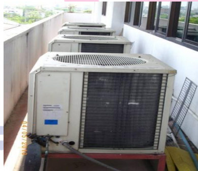
(ก) ระบบปรับอากาศ
