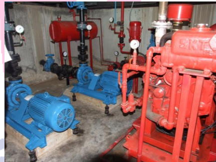
(ข) ระบบปั๊มน้ำ
