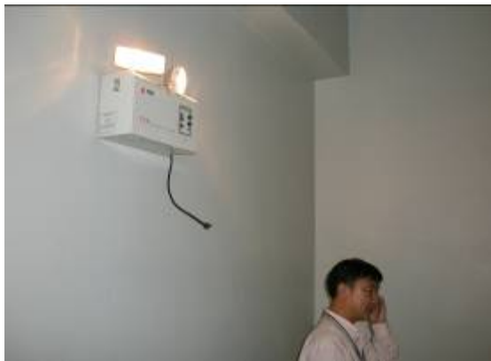
ภาพที่ 4.15 มีไฟฉุกเฉินและใช้งานได้
