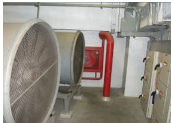
ภาพที่ 4.17 พัดลมอัดอากาศในบันไดหนีไฟ
