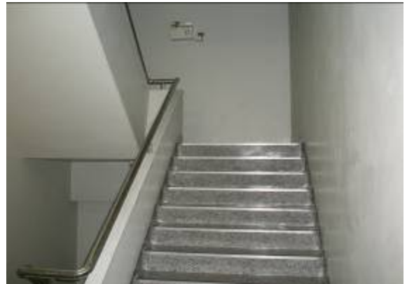
ภาพที่ 4.13 บันไดหนีไฟไม่เป็นแบบบันไดเวียน
