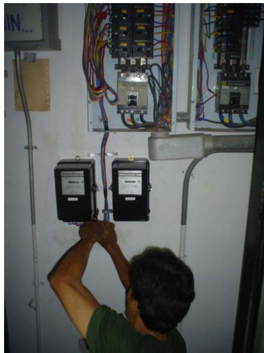
ภาพประกอบที่ ๓.4 การติดตั้ง Kilowatt-hour meter ในห้องควบคุมไฟฟ้า ชั้น 12
