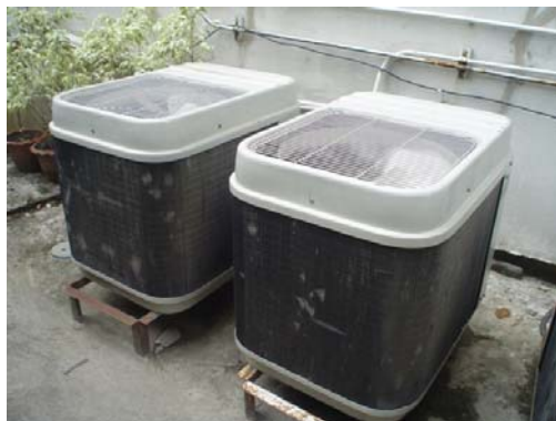
ภาพประกอบที่ 9 คอนเดนซิ่งยูนิต (Condensing Unit) ของเครื่องปรับอากาศแบบแยกส่วน
