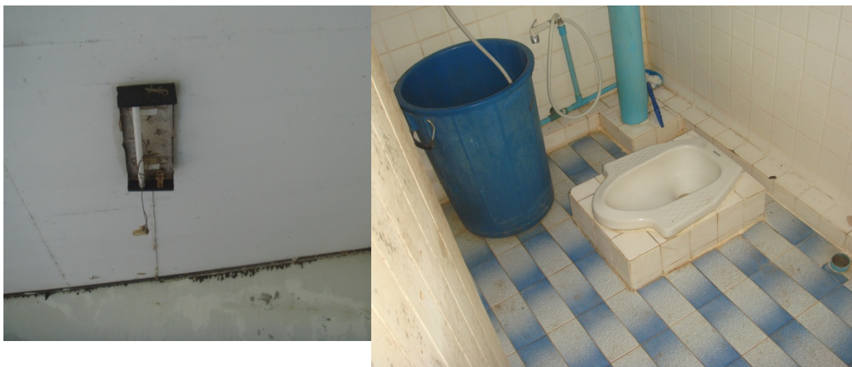
ภาพสภาพไฟแสงสว่างและสภาพห้องน้ำในตัวอาคาร
