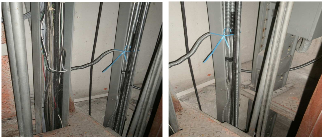
ภาพประกอบที่ 4.1.10 สภาพภายในช่องเปิดแนวตั้งของระบบไฟฟ้า
