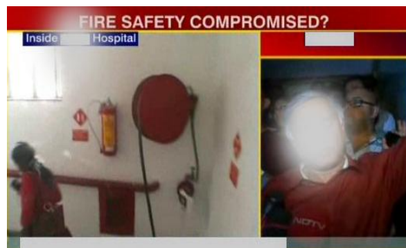
ภาพประกอบที่ 2.6 ระบบอุปกรณ์ดับเพลิงติดตั้งในตำแหน่งที่ไม่ได้มาตรฐาน
