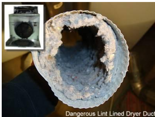
ภาพประกอบที่ 2.3 ช่องท่องานระบบระบายอากาศเสียหายหลังจากเพลิงไหม้
