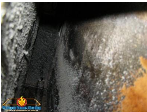
ภาพประกอบที่ 2.2 ช่องรางระบบไฟฟ้าเสียหายหลังจากเพลิงไหม้
