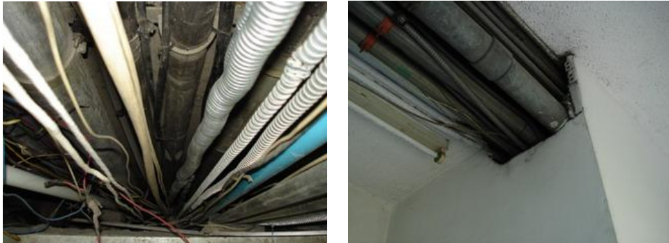
ภาพประกอบที่ 4.1 ช่องงานระบบต่างๆไม่การติดตั้งวัสดุป้องกันไฟลาม
