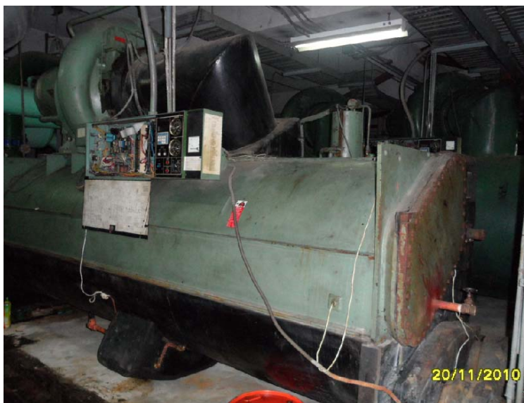
ภาพประกอบที่ 1 เครื่องทำน้ำเย็น (Chiller) ของอาคารเสริมมิตร ทาวเวอร์
