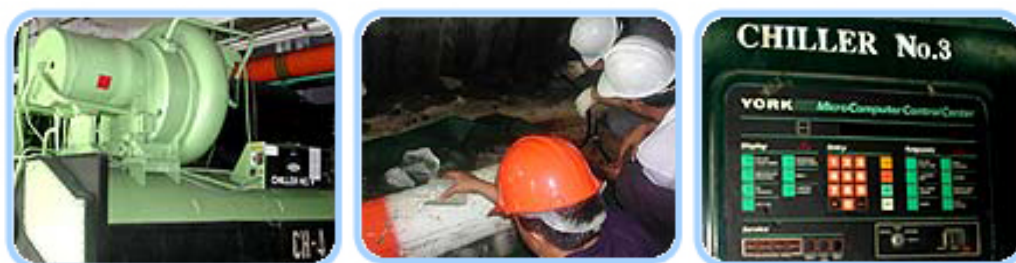
ภาพประกอบที่ 4 การเปลี่ยนเครื่องทำน้ำเย็น (Chiller) ที่ใช้สาร ซีเอฟซี
