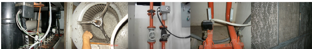
ภาพที่ 7 ส่วนประกอบอุปกรณ์ห้องจ่ายความเย็น
