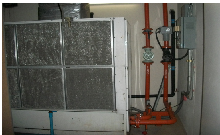
ภาพที่ 6 ภาพถ่าย ห้องจ่ายความเย็น ของระบบปรับอากาศแบบ PACKAGE WATER COOLED
