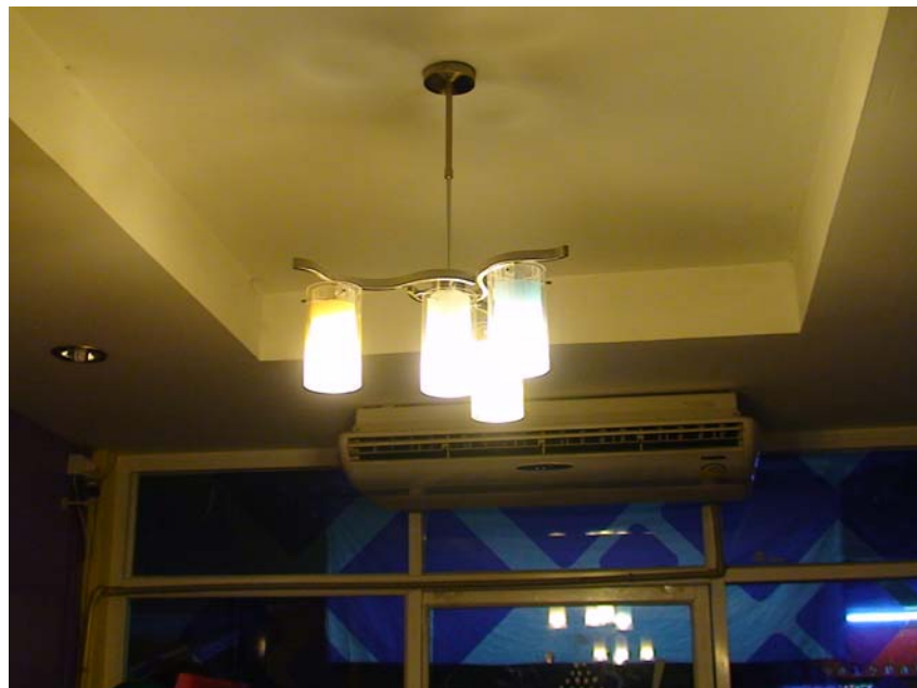
ภาพที่ 11 ความสว่างของโคมไฟ ขณะมีการใช้งาน
