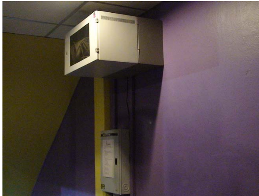
ภาพที่ 17 ตู้จ่ายไฟบนชั้นสอง
