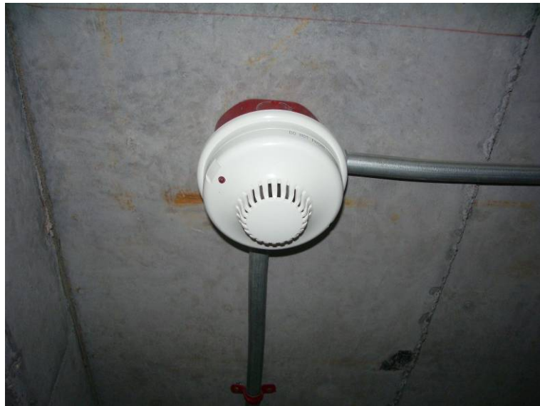
รูปที่ 4.14 Smoke detector
