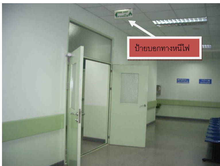
รูปที่ 4.8 ป้ายบอกทางหนีไฟบริเวณทางเดิน
