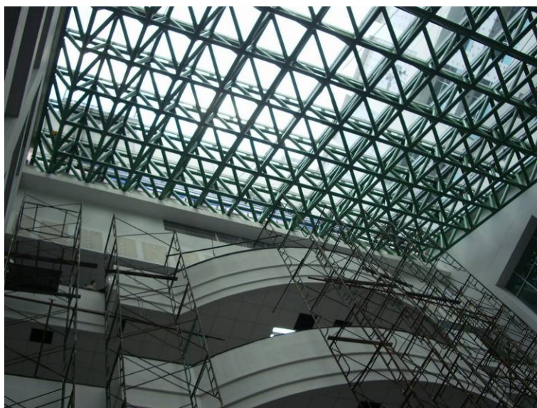
รูปที่ 4.9 แสดง Atrium ด้านหน้าอาคารซึ่งไม่มีระบบควบคุมควันไฟ
