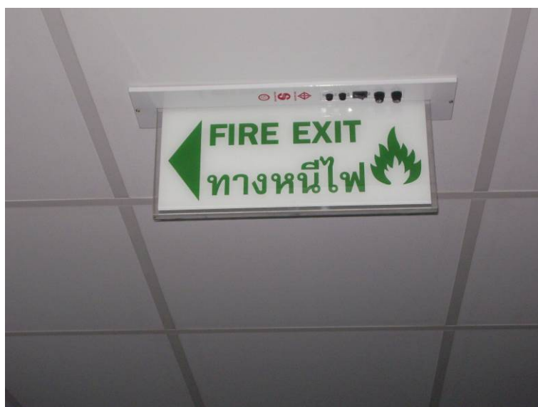
รูป 4.24 ไฟป้ายทางหนีไฟไม่ติด ไม่มี check sheet
