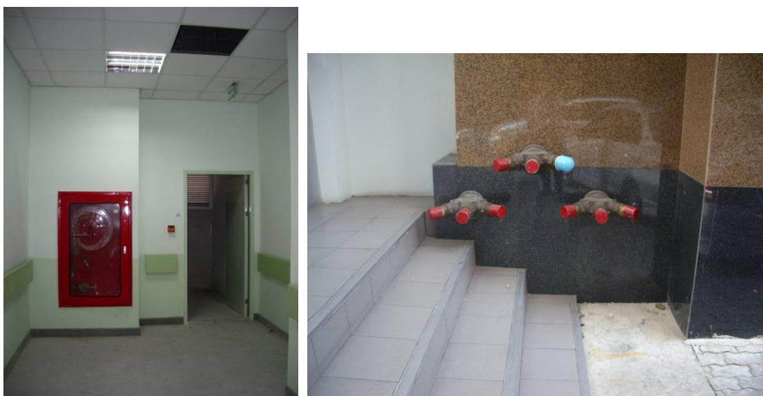
รูป 4.16 ตู้ดับเพลิง และหัวรับน้ำดับเพลิง
