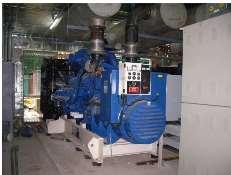
รูปที่ 4.10 เครื่องกำเนิดไฟฟ้าสำรอง
