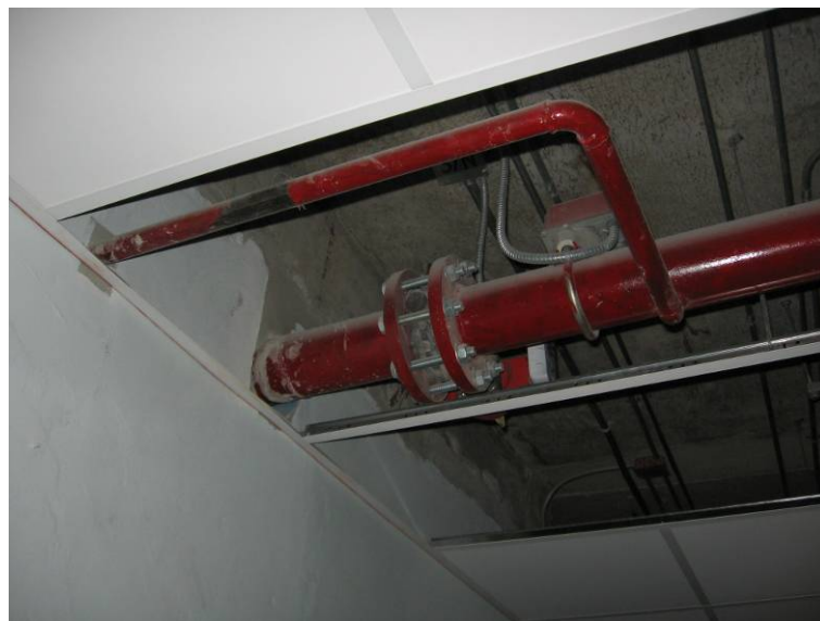
รูปที่ 4.26 วาล์วควบคุมการทำงานของท่อน้ำสปริงเกอร์
