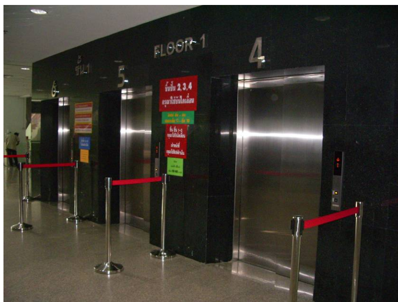
รูปที่ 4.3 หน้าโถงลิฟต์ไม่มีแผนผังแสดงตำแหน่งทางหนีไฟหรืออุปกรณ์ดับเพลิง
