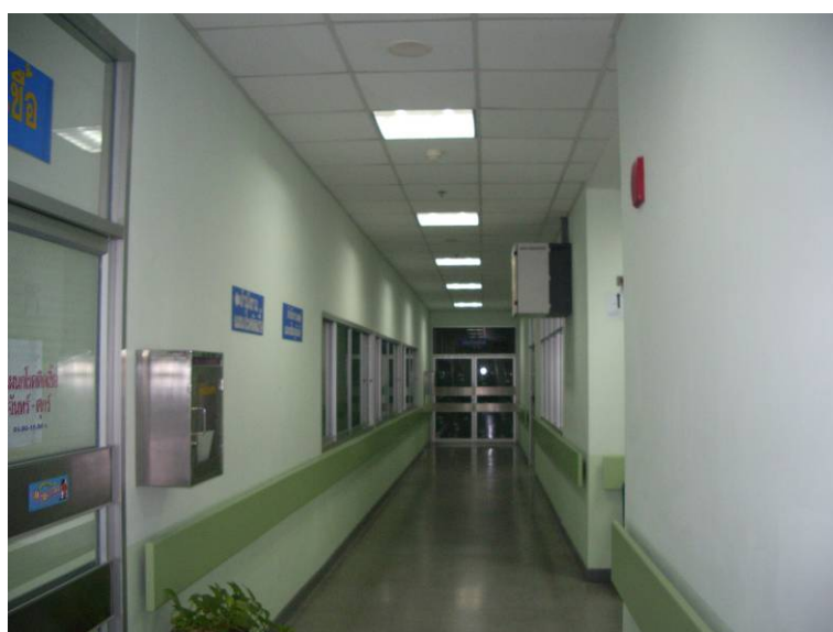
รูปที่ 4.29 ทางเดินภายในแผนกไม่มีไฟป้ายหรือเครื่องหมายทางออกฉุกเฉิน
