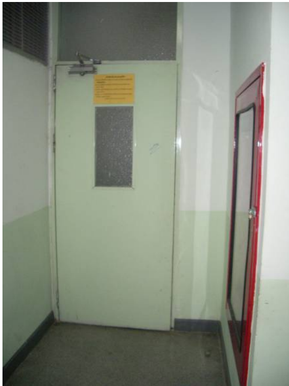
รูปที่ 4.12 ตู้ดับเพลิงและประตูทางหนีไฟชั้นล่าง
