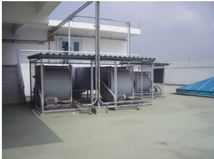
รูปที่ 4.13 พัฒมอัดอากาศบันไดหนีไฟและโถงหน้าลิฟต์ดับเพลิง
