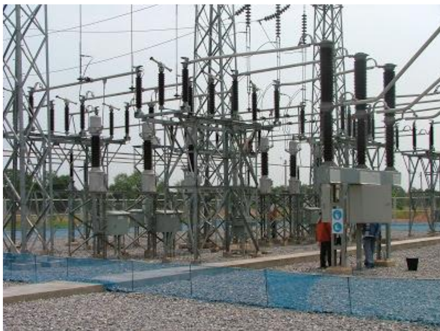
ภาพที่ 2.16 สถานีไฟฟ้า
