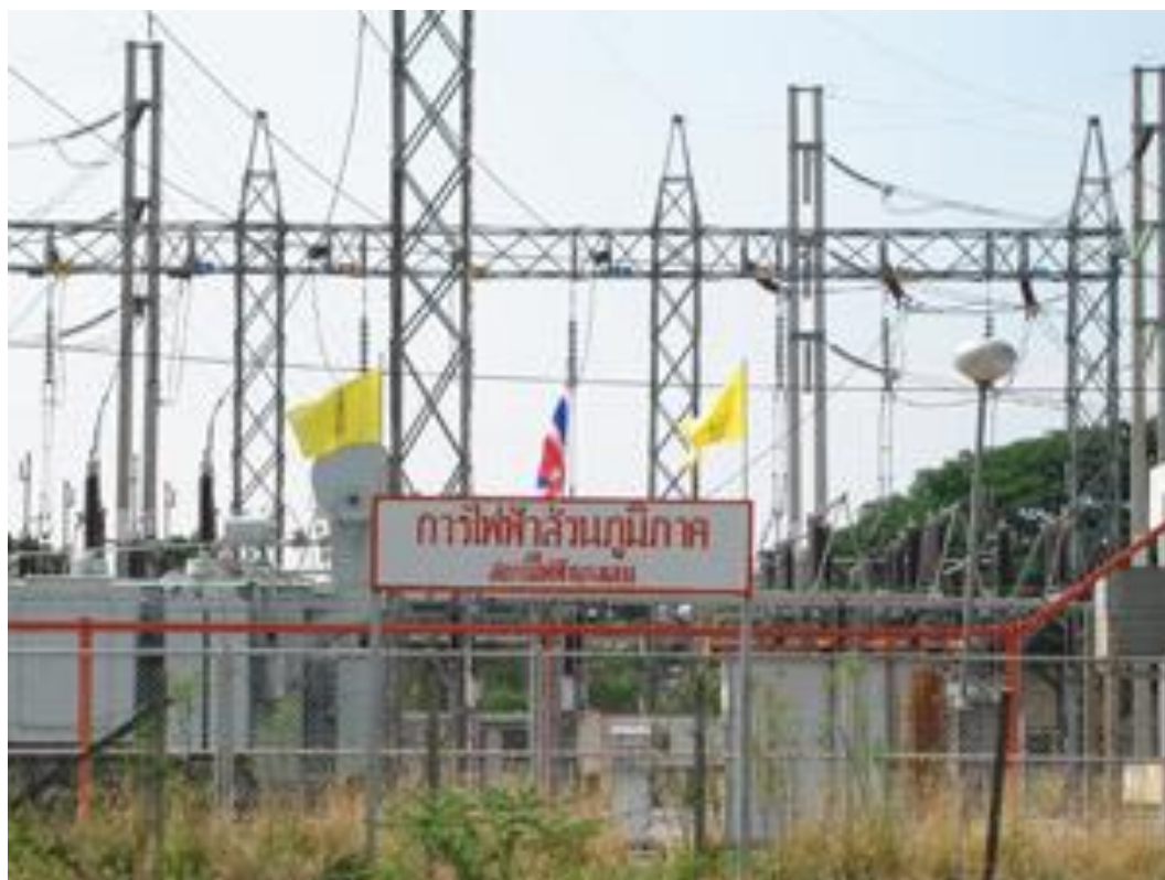
ภาพที่ 2.14 สถานีไฟฟ้าย่อยจำหน่าย (Secondary Substation)
