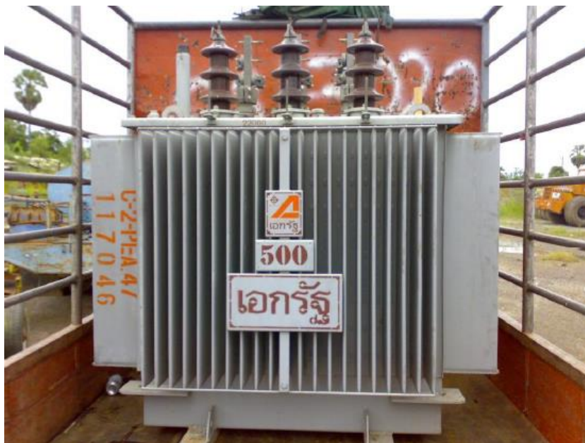
ภาพที่ 2.37 หม้อแปลงจำหน่าย (Distribution Transformer)
