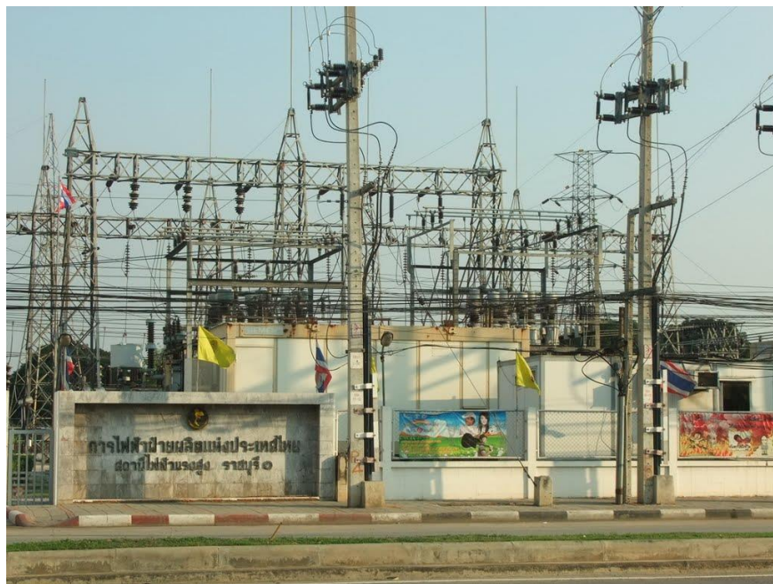
ภาพที่ 2.12 สถานีไฟฟ้าย่อยต้นทาง Primary Substation
