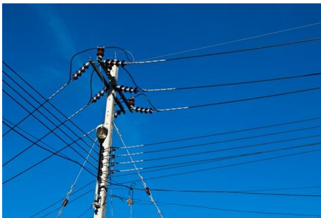
ภาพที่ 2.15 สายจำหน่ายแรงสูงหรือสายป้อน
