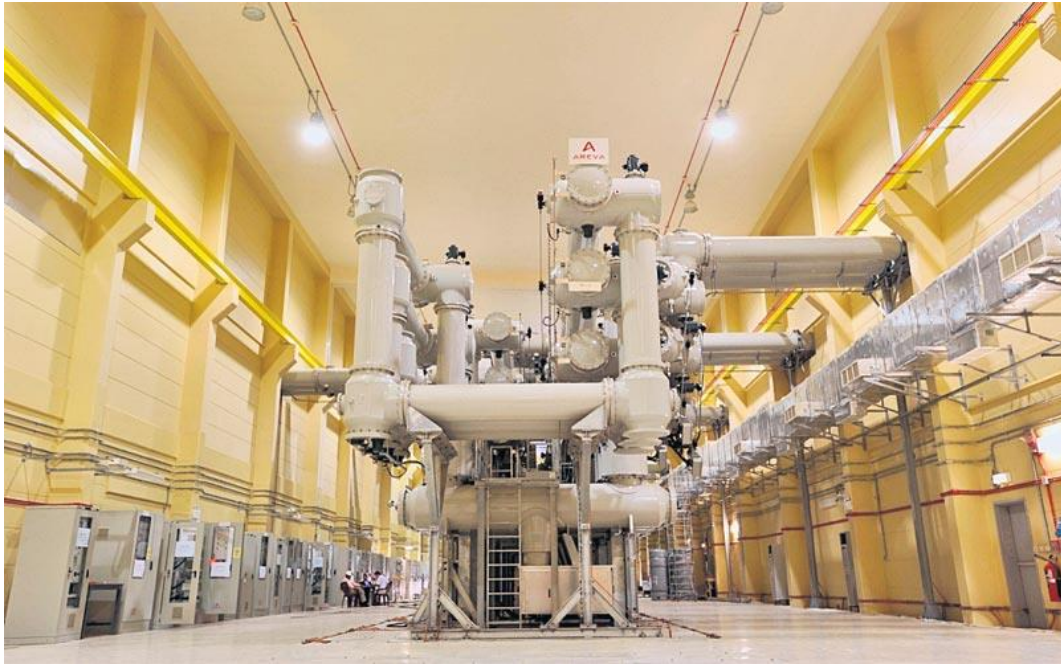
ภาพที่ 2.18 สถานีไฟฟ้าแรงสูงแบบ GIS แบบภายในอาคาร
