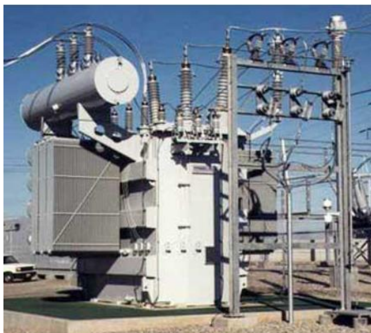
ภาพที่ 2.36 หม้อแปลงไฟฟ้ากำลัง Power Transformer
