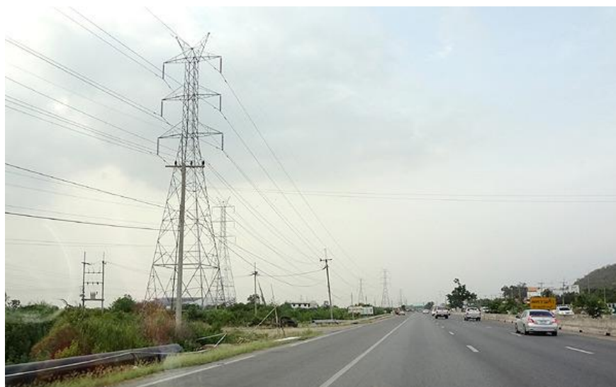
ภาพที่ 2.13 สายส่งไฟฟ้าย่อย (Sub Transmission Line)
