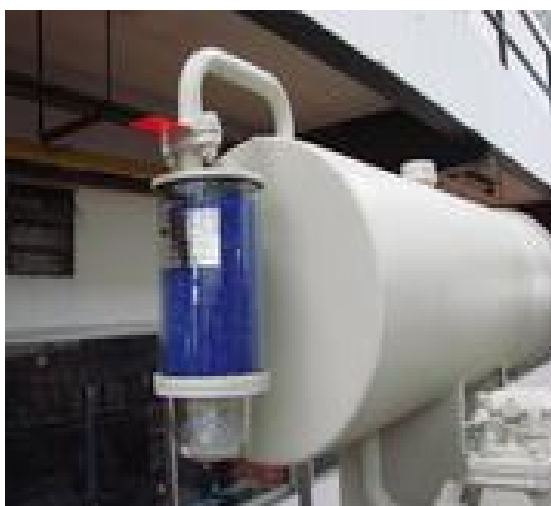
ภาพที่ 2.33 Conservator และ Air Dryer
