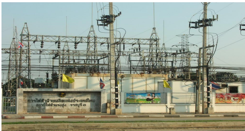
ภาพที่ 2.13 สถานีไฟฟ้าย่อยต้นทาง (Primary Substation)
