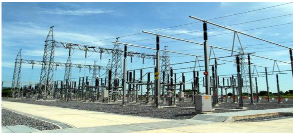
ภาพที่ 2.10 สถานีไฟฟ้าย่อยแปลงแรงดันสูงหรือลานไกไฟฟ้า (Step-Up Substation Or Switch Yard)
