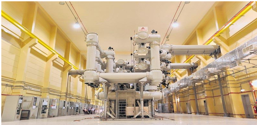
ภาพที่ 2.19 สถานีไฟฟ้าแรงสูงแบบ GIS แบบภายในอาคาร
