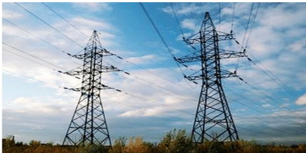
ภาพที่ 2.11 สายส่งไฟฟ้าในลักษณะเหนือศีรษะ
