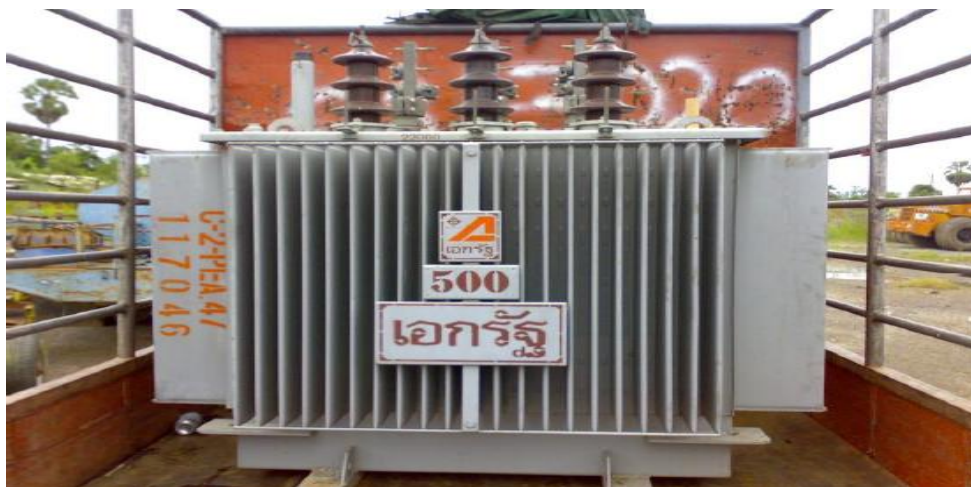
ภาพที่ 2.38 หม้อแปลงจำหน่าย (Distribution Transformer)
