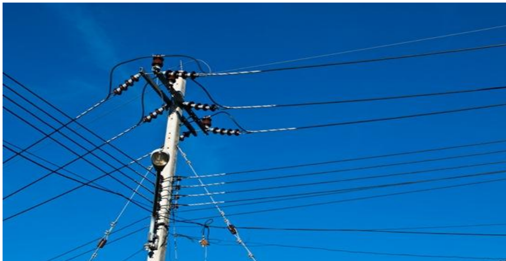
ภาพที่ 2.16 สายจำหน่ายแรงสูงหรือสายป้อน
