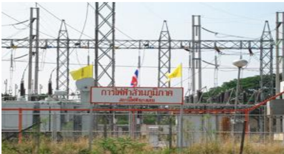
ภาพที่ 2.15 สถานีไฟฟ้าย่อยจำหน่าย (Secondary Substation)
