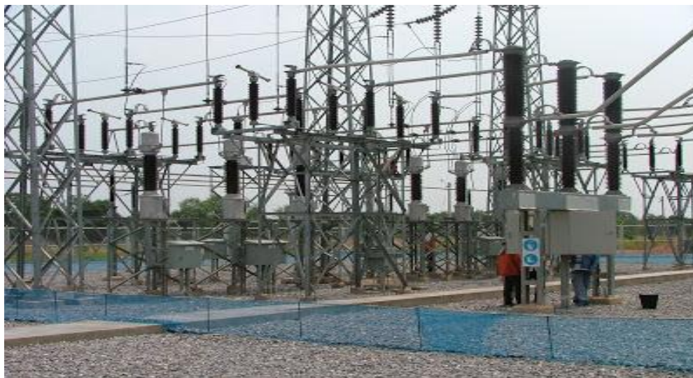
ภาพที่ 2.17 ภาพจริงของสถานีไฟฟ้าย่อย
