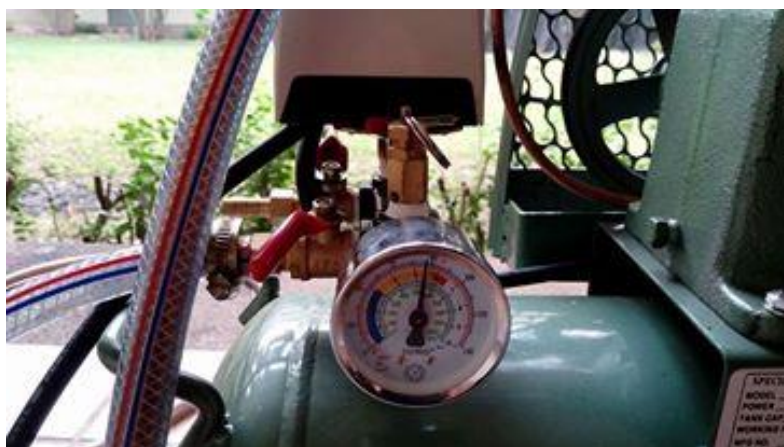
ภาพที่ 4.18 การเปิดวาล์วเครื่องปั๊มลม
