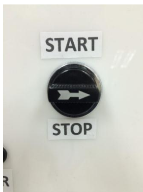
ภาพที่ 3.11 สวิตช์ควบคุมมอเตอร์
