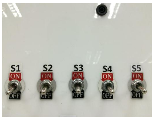
ภาพที่ 3.12 สวิตช์ควบคุมหลอดไฟ
