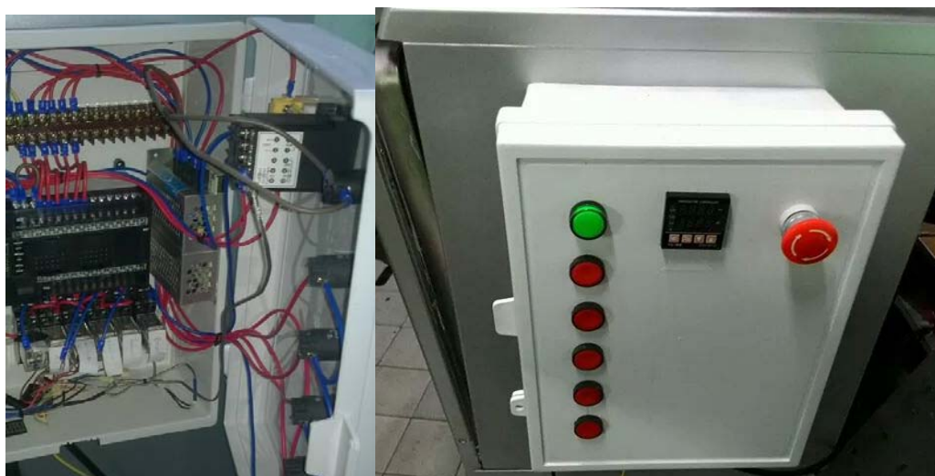
ภาพที่ 4.5 ตู้ควบคุมควบคุมและPLC
