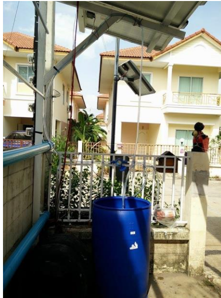
ภาพที่ 4.9 การทดสอบระบบสูบน้ำ จากแผงโซลาร์เซลล์ โดยตรงไม่ผ่านแบตเตอรี่
