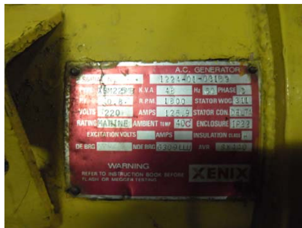
ภาพที่ 3.3 Name Plate ของGenerator
