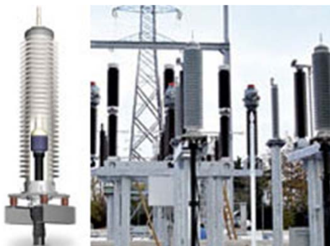
ภาพที่ 1.2 หัวต่อสายไฟฟ้าแรงสูงในลานไก
