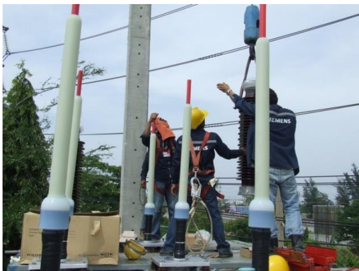
ภาพที่ 3.2 การติดตั้งและวัดระยะของอุปกรณ์ควบคุมความเครียดสนามไฟฟ้า (Stress Cone)
