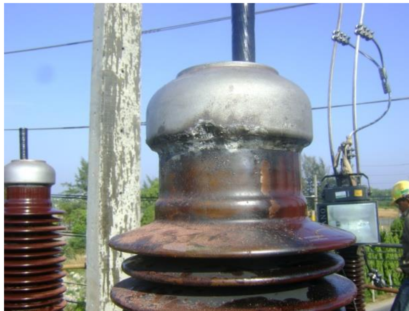
ภาพที่ 3.7 หัวต่อสายไฟฟ้าแรงสูงที่เกิดระเบิด
