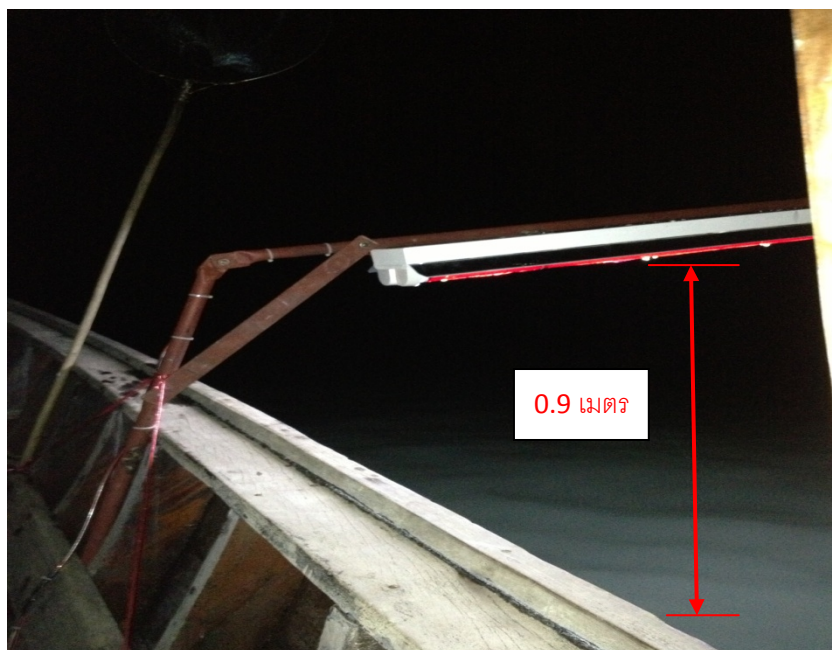
ภาพที่ 3.7 ติดตั้งโคมไฟหลอด LED จำนวน 1 โคม
