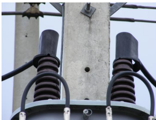
ภาพที่ 3.2 อุปกรณ์ ครอบหัวขซึ่งหม้อแปลง ไฟฟ้าด้านแรงสูง
