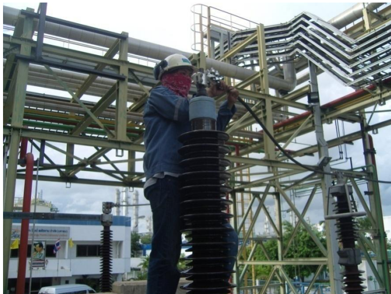
ภาพที่ 4.1 วิธีการปลดโหลดของหม้อแปลงไฟฟ้ากำลัง
