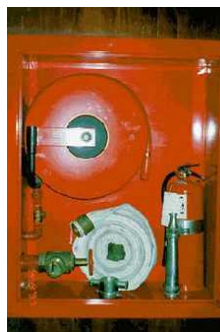
รูปที่ 4.16 fire hose cabinet
