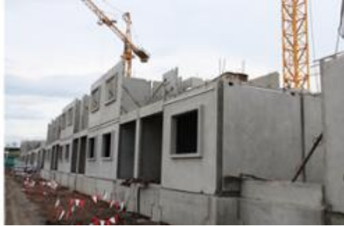
รูปที่ 4.19 แสดงตัวอย่างโครงสร้างแบบแผ่นคอนกรีตสำเร็จรูป
