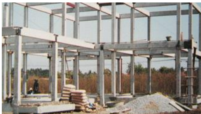
รูปที่ 4.18 แสดงตัวอย่างโครงสร้างแบบ เสา-คาน
