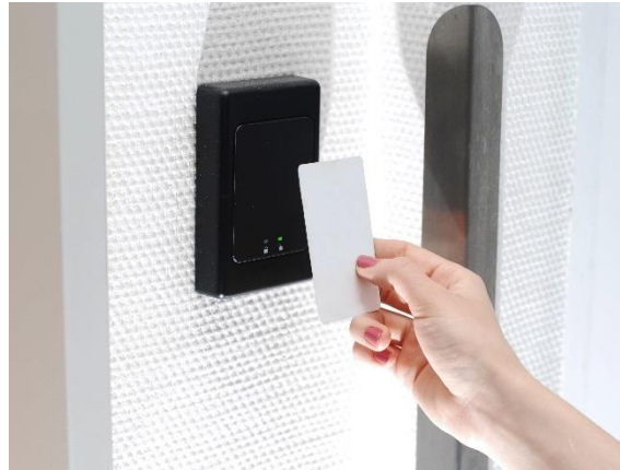
ภาพที่ 4. 17 ระบบควบคุมประตู
