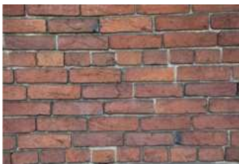
รูปภาพที่ 2.59 รูปด้านของการก่ออิฐแบบ FACING BOND
