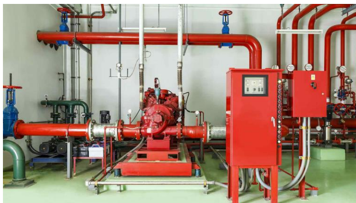
รูปภาพที่ 51 Fire Pump Systems
