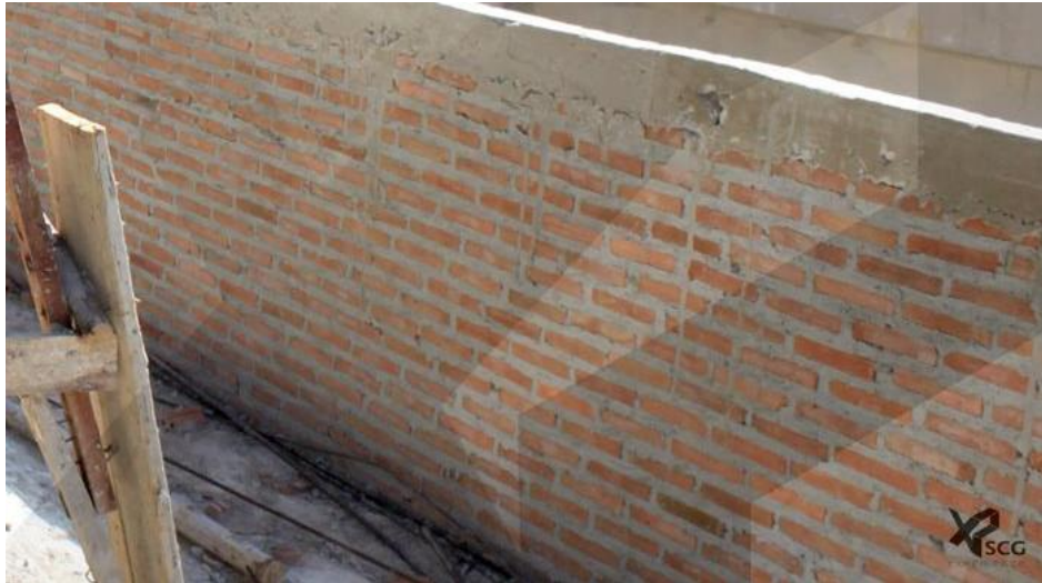
รูปที่ 4 ผนังก่ออิฐครึ่งแผ่นความหนา 10 เซนติเมตร ที่มา : SCG Experience,2561
