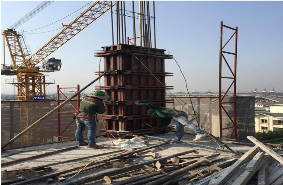
รูปที่ ค 9 แสดงการทำงานกิจกรรมงานถอดไม้แบบเสา
