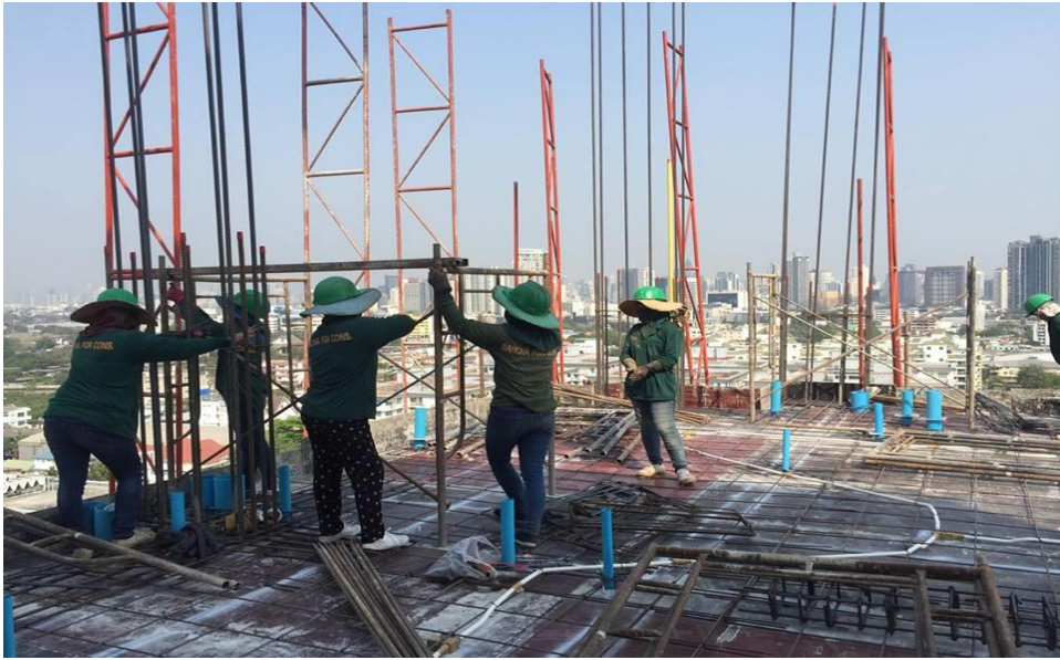
รูปที่ ค 1 แสดงการทำงานกิจกรรมงานติดตั้งนั่งร้าน
