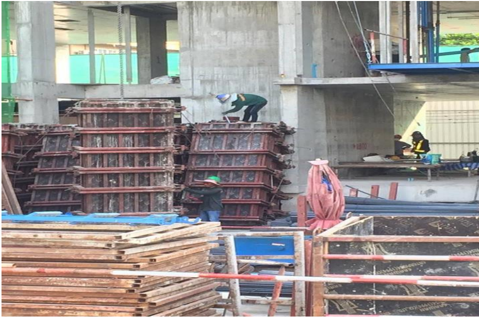
รูปที่ ค 3 แสดงการทำงานกิจกรรมงานทำไม้แบบเสาะ
