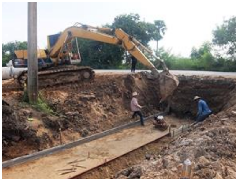
รูปที่ ค.4 การเตรียมไม้แบบและการติดตั้งไม้แบบเพื่อจะทำการเทคอนกรีต
