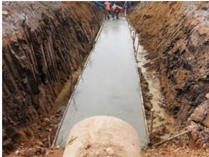
รูปที่ ค.5 ทำการเทคอนกรีตลงไปแบบที่เตรียมเอาไว้
