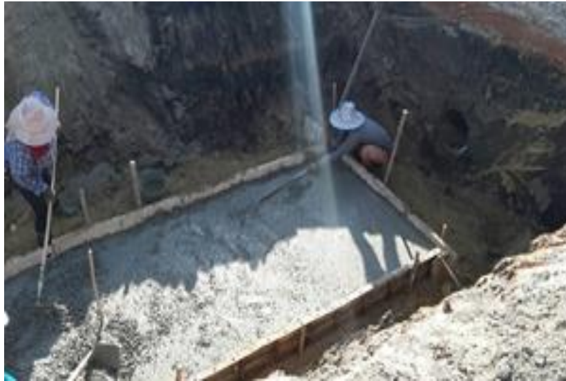
รูปที่ ค.5 ทำการเทคอนกรีตลงไปแบบที่เตรียมเอาไว้
