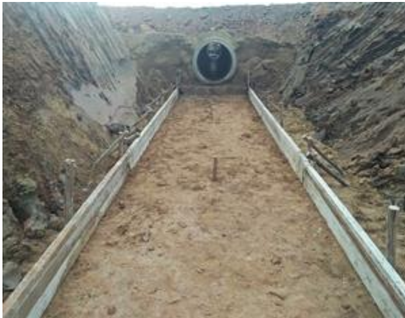
รูปที่ ค.4 การเตรียมไม้แบบและการติดตั้งไม้แบบเพื่อจะทำการเทคอนกรีต
