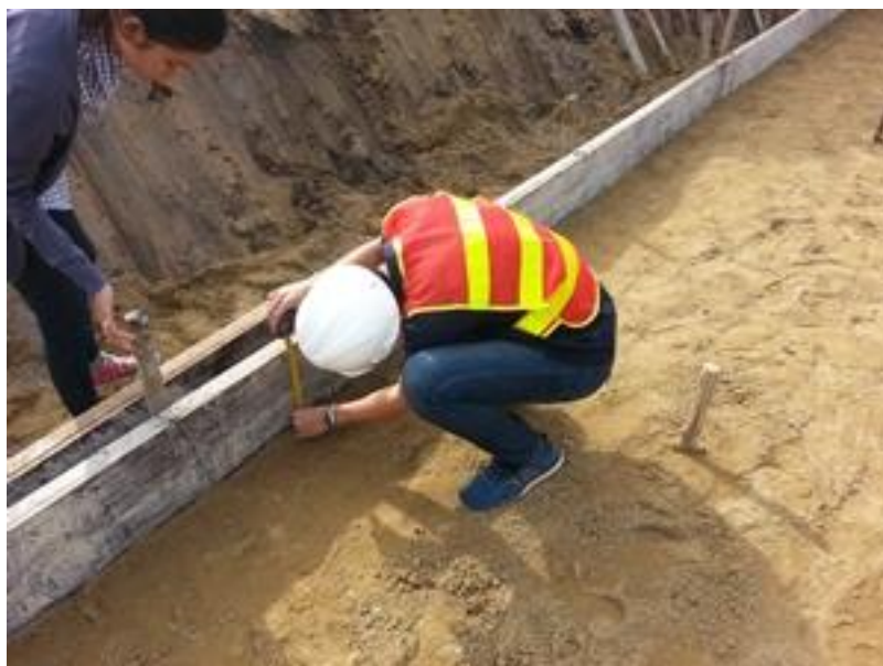
รูปที่ ค. 4 การเตรียมไม้แบบและการติดตั้งไม้แบบเพื่อจะทำการเทคอนกรีต
