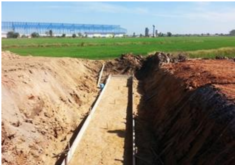
รูปที่ ค.4 การเตรียมไม้แบบและการติดตั้งไม้แบบเพื่อจะทำการเทคอนกรีต
