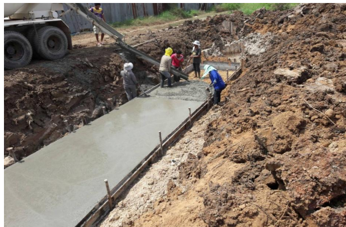
รูปที่ 1.1 การเทพื้นเพื่อวางท่อระบายน้ำคอนกรีตเสริมเหล็ก
