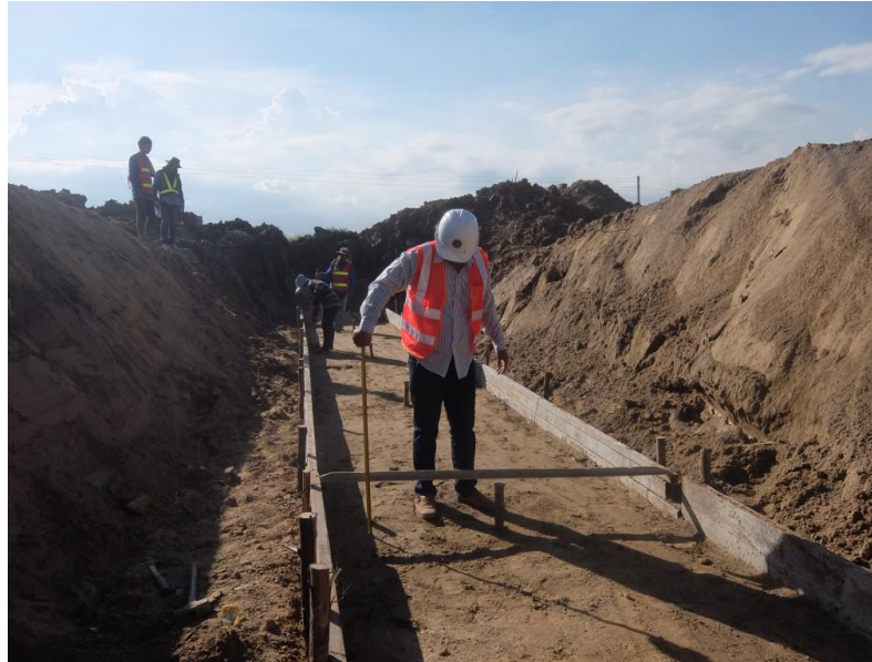
รูปที่ 3.11 รูปแสดงการวัดแบบที่ติดตั้งเสร็จแล้ว
