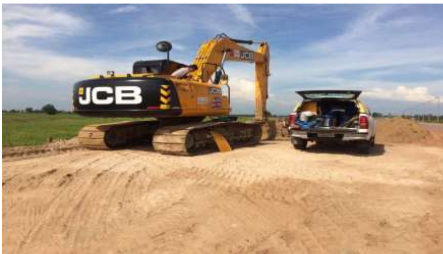
รูปที่ 2.7 เครื่องจักรเกิดการชำรุดกำลังดำเนินการซ่อมแซม
