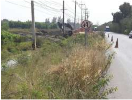
งานกรุยแนวทางและขุดต่อ กม. 4+500 – 4+800 LT
