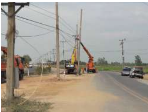
งานรื้อย้ายสาธารณูปโภคไฟฟ้ากีดขวางการก่อสร้าง กม.18+100
