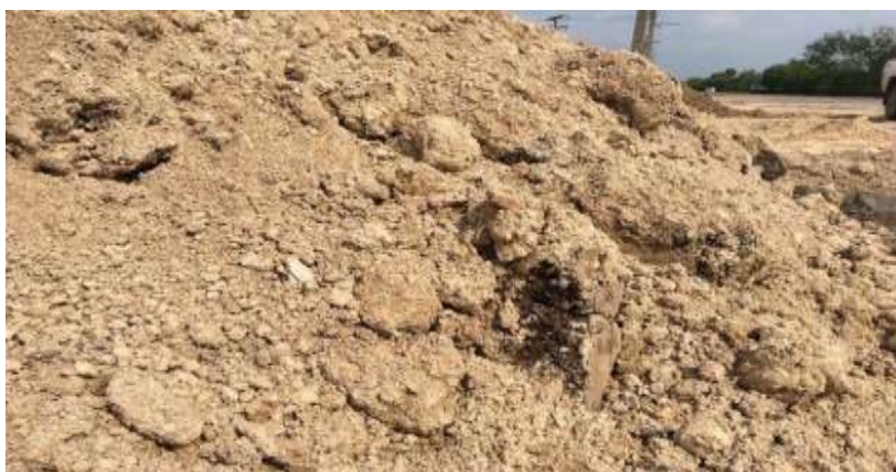
รูปที่ 3.7 ขั้นตอนการลงทรายถมคันทาง : ตรวจพบทรายปนเปื้อน
