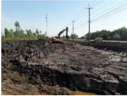
งานกรุยแนวทางและขุดตอ กม. 10+050 – 10+300 LT
