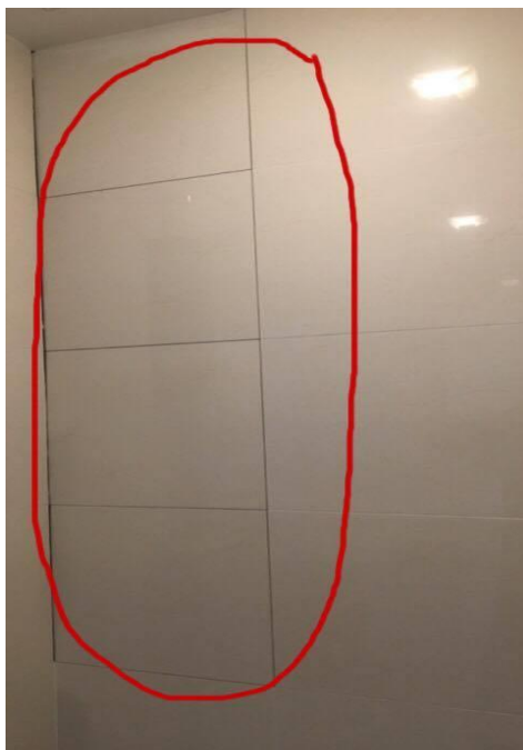
รูปที่ ก 11 กระเบื้องร่อนและร่องไม่ตรงกัน
