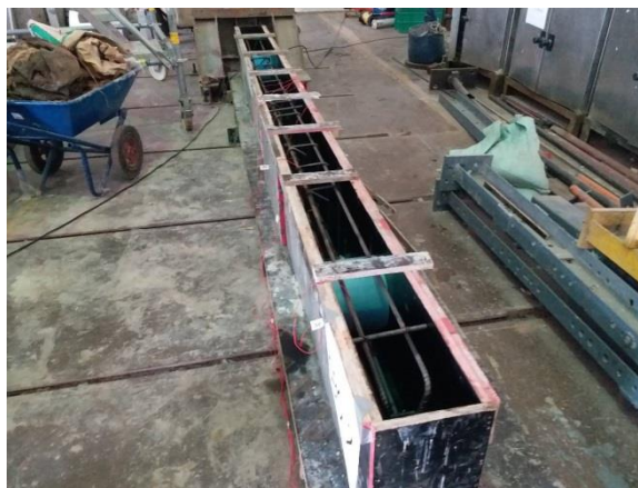
รูปที่ 3.1.9 การเข้าแบบและติดตั้งค้ำยันคาน
