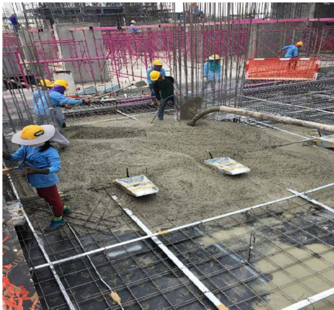
รูปที่ 1.1 พฤติกรรมการทำงานของคนงานในการเทคอนกรีต
