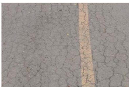
รูปที่ 2.4 รอยแตกรอยแตกหนังจระเข้ (Alligator Crack)
