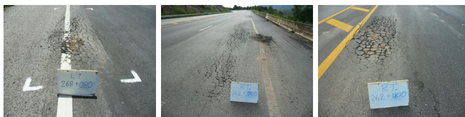
รูปที่ 4.1 รูปแสดงความเสียหายแบบรอยแตกหนังจระเข้ (Alligator Crack) ในภาคสนาม
