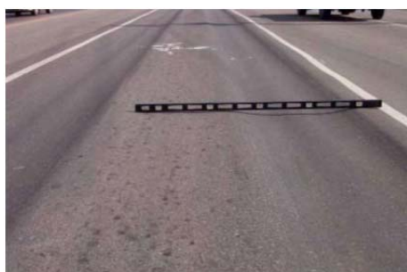
รูปที่ 2.5 ร่องล้อ (Rutting)
