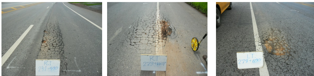
รูปที่ 1.1 ความเสียหายที่เกิดขึ้นบนทางหลวงหมายเลข 12 ตอน วังทอง – เช็กน้อย
