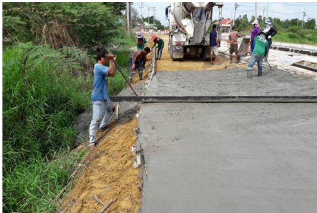
รูปที่ 1.1 แบบแตกขณะเทคอนกรีตงานผิวจราจรคอนกรีต
