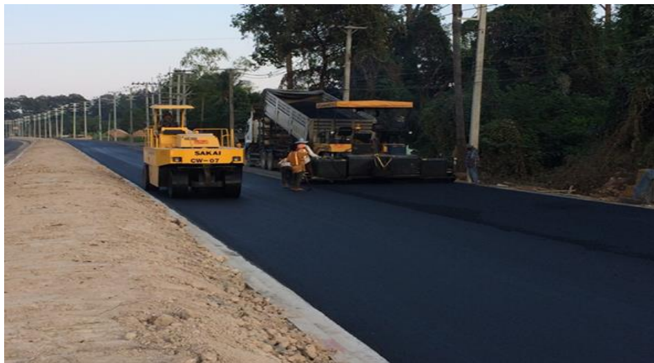
รูปที่ ข 6 แสดงลักษณะการทำงาน (ปูยางแอสฟัลต์ติกคอนกรีตและบดทับ)
