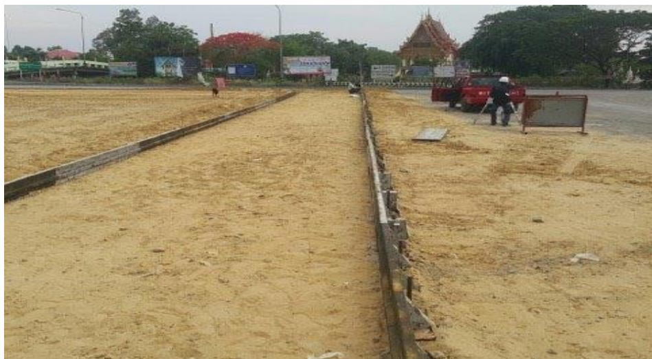
รูปที่ ข 10 แสดงลักษณะการทำงาน (ติดตั้งไม้แบบ)
