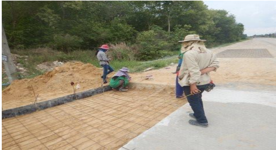
รูปที่ ข 11 แสดงลักษณะการทำงาน (ติดตั้งเหล็กเสริม)
