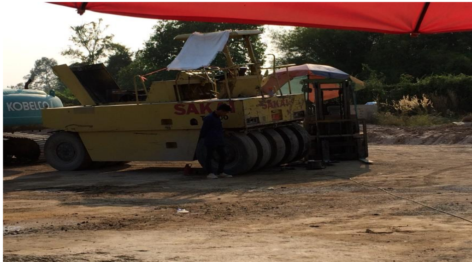
รูปที่ ๗ แสดงลักษณะความเสี่ยง (รถบดล้อยางเสีย)
