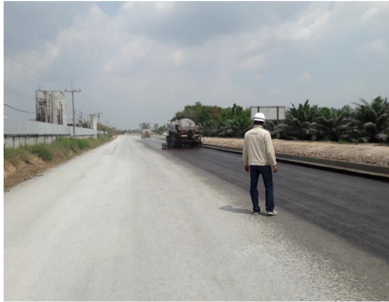
รูปที่ ข 5 แสดงลักษณะการทำงาน(ลาดน้ำยาง Prime Coat)
