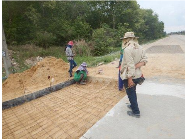
รูปที่ ข 11 แสดงลักษณะการทำงาน (เข้าแบบผิวจราจรคอนกรีต)
