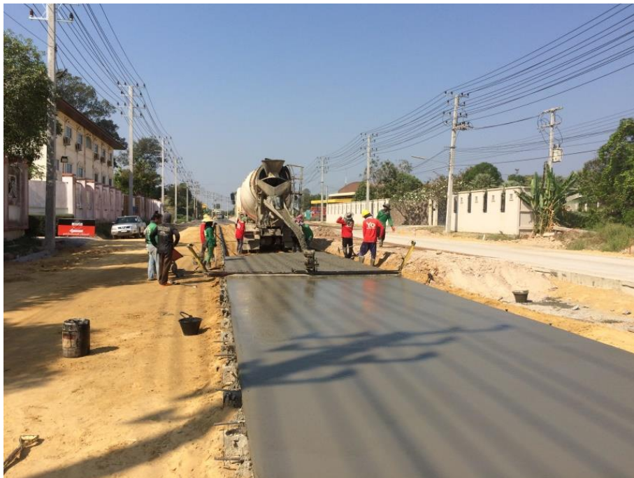
รูปที่ ข 12 แสดงลักษณะการทำงาน (เทคอนกรีตผิวจราจรเสริมเหล็ก)
