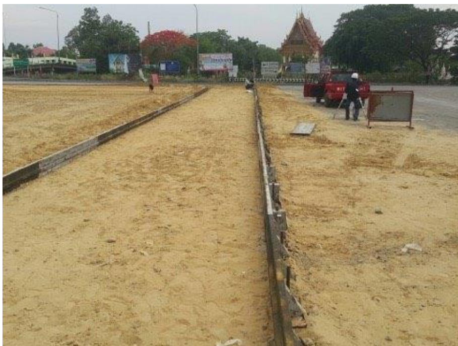
รูปที่ ข 10 แสดงลักษณะการทำงาน (ติดตั้งไม้แบบ)
