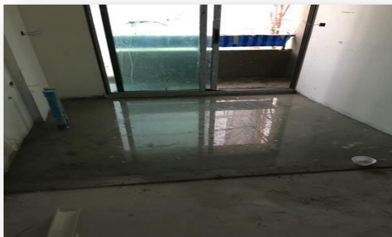
รูปที่ 2.2 พายุฝนทำให้เกิดน้ำท่วมขังในส่วนของระเบียง และห้องครัวก่อให้เกิดความเสี่ยงทำให้งานล่าช้า
