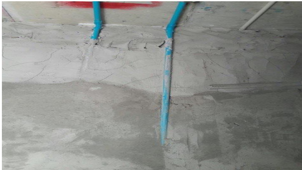
รูปที่ 3.14 ความเสี่ยงที่เกิดจากท่อประปาล้นผนังหลังจากการฉาบไม่สามารถปูกระเบื้องต่อได้จำเป็นต้องมีการเจาะผนังเพื่อปรับตำแหน่งท่อประปาใหม่
