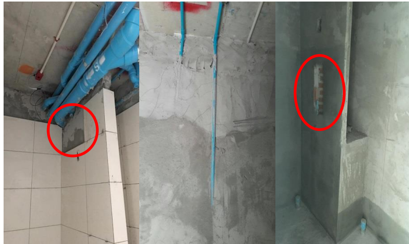
รูปที่ ข 8 รูปแสดงความเสี่ยงที่เกิดจากท่อของงานระบบและการเจาะผนังจัดท่อใหม่
