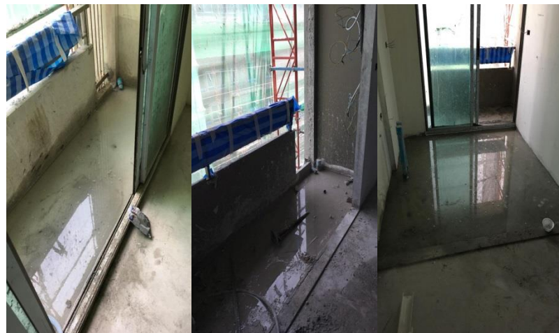
รูปที่ ข 9 รูปแสดงความเสี่ยงที่เกิดจากฝนเกิดน้ำท่วมขังในส่วนของระเบียงและห้องครัว
