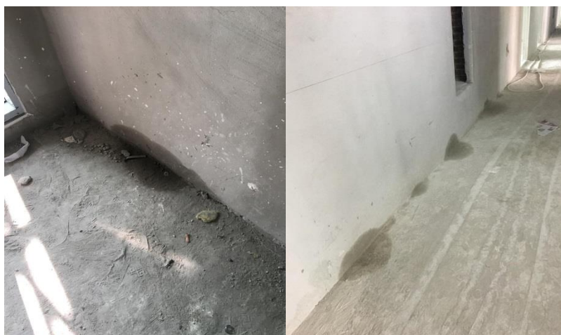
รูปที่ ข 11 รูปแสดงความเสี่ยงที่เกิดจากการชั่งน้ำเพื่อตรวจกันซึมห้องน้ำแล้วซึมผ่านผนัง
