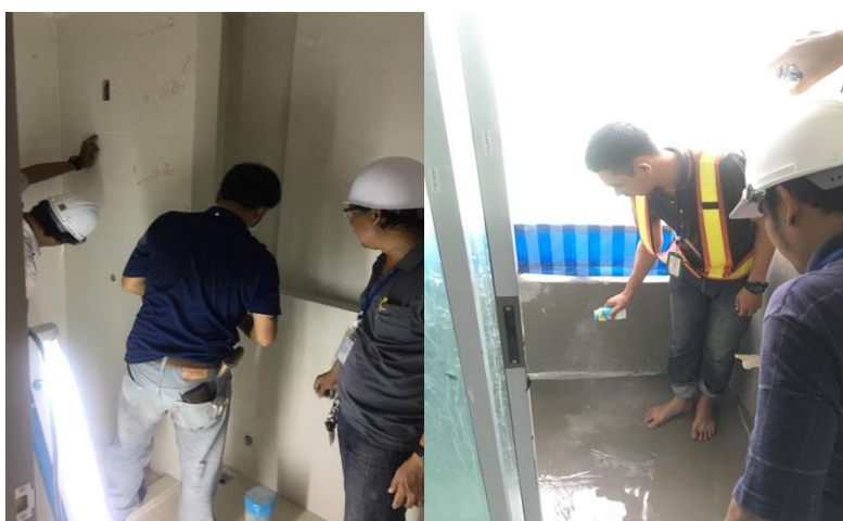
รูปที่ ข 6 รูปแสดงการตรวจกระเบื้อง และ Slope ของพื้นระเบียง
