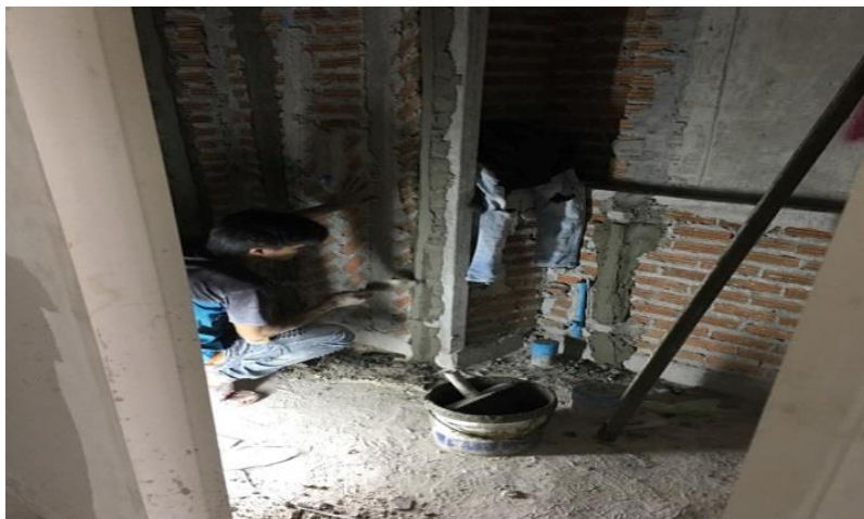
รูปที่ ข 1 รูปแสดงการจับปั๊มภายในห้องน้ำ
