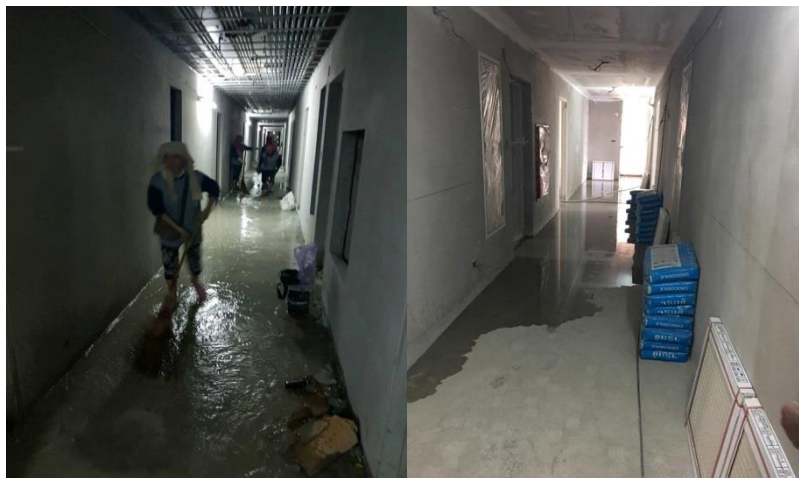
รูปที่ ข 10 รูปแสดงความเสี่ยงที่เกิดจากคนงานเปิดน้ำก๊อกน้ำทิ้งไว้ทั้งคืนทำให้น้ำท่วมชั้น
