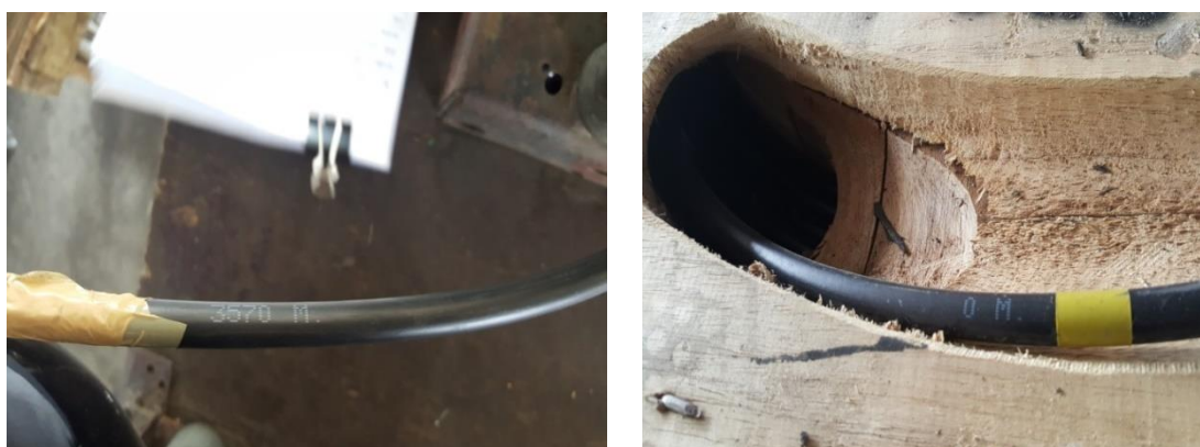
ภาพที่ 4.6 หัวสายปลายสายไฟ
