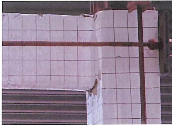
ภาพที่ 4.8 เกิดรอยแยกที่บริเวณรอยต่อเสา-คานที่การเคลื่อนที่สัมพัทธ์ +4.23% (BF-SR)
