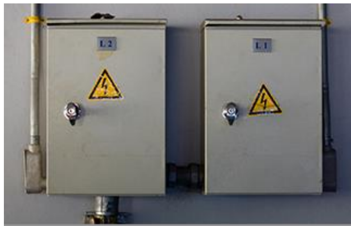
แผงเมนไฟฟ้า
