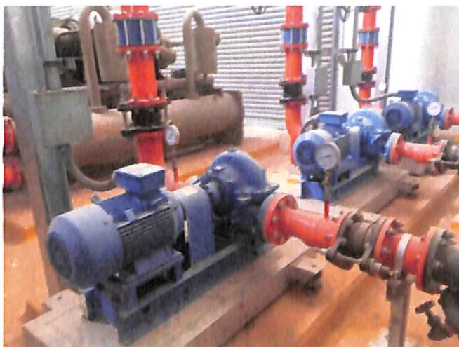
รูปที่ 2.7 เครื่องสูบน้ำระบายความร้อน
