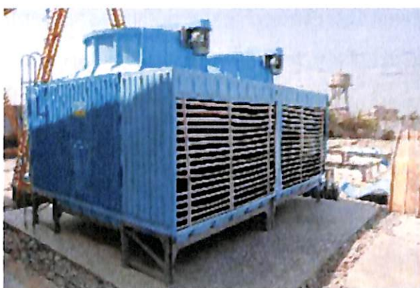
รูปที่ 2.8 หอหล่อเย็น (Cooling Tower) [1]
