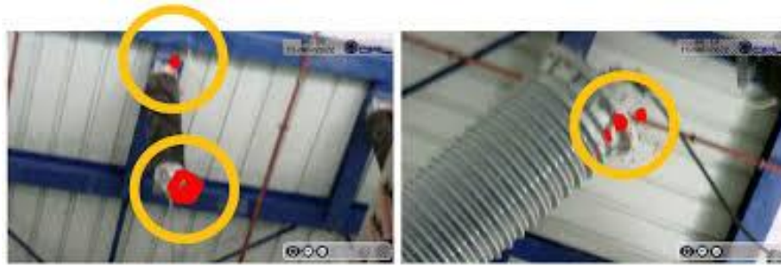
รูปที่ 2 การแตกตัวของอากาศโดยรอบจุดที่เกิด PD ที่สังเกตได้จากกล้องถ่ายภาพ
